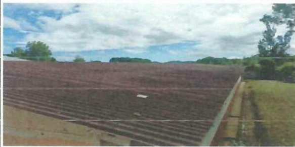
Foto 1: Cubierta de lámina módulo 2 con goteras en aula de primero B
