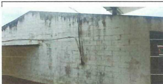
Foto 8: Pintura deteriorada modulo 1
