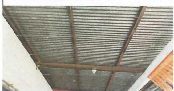
Foto 2: Estructura de lámina módulo 2 es necesario pintar
